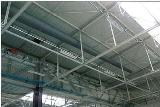
L'atelier de "ferrage" du constructeur automobile est chauffé par des centrales make-up en tout air neuf. L'air est diffusé par un réseau de 449 m de conduits textiles de forme tronconique. Ces conduits jouent un rôle actif en permettant notamment d'éviter les courants d'air et les phénomènes de stratification de températures.
