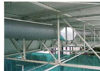
Les conduits sont alimentés par six centrales make-up de 90 000 m³/h fonctionnant en tout air neuf, installées sous la toiture, dans la charpente.
